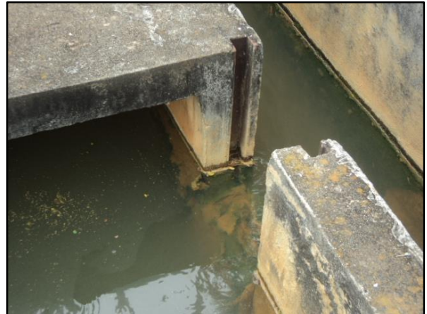
Figura 18 – Tanque de floculação
