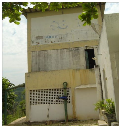
Figura 24 - Vista da ETA Avelar 2
