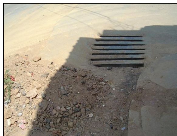
Figura 36 – Terra que estava obstruindo a boca de lobo
