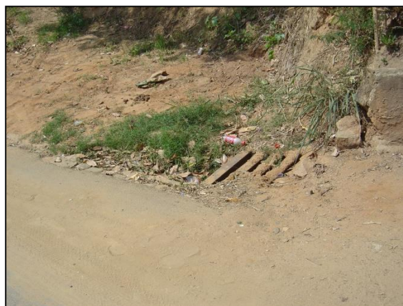
Figura 38 – Caixa de captação obstruída com terra e lixo
