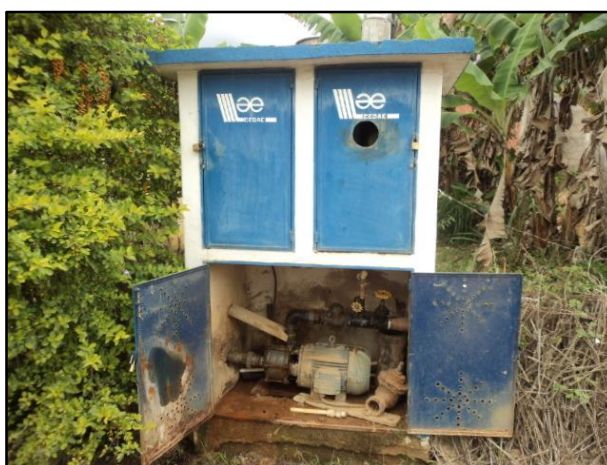
Figura 27 – Sistema de bombeamento
