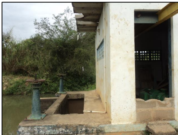
Figura 11 – Estação elevatória de água bruta - vista 1
