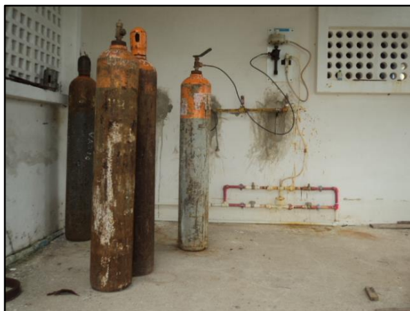
Figura 21 – Cilindros de cloro
