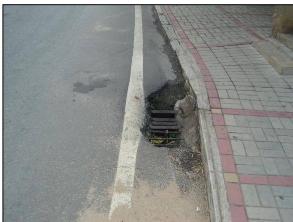
Figura 37 – Boca de lobo em péssimo estado de conservação 1
