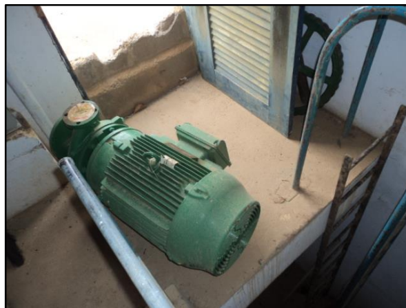
Figura 12 – Estação elevatória de água bruta - vista 2
