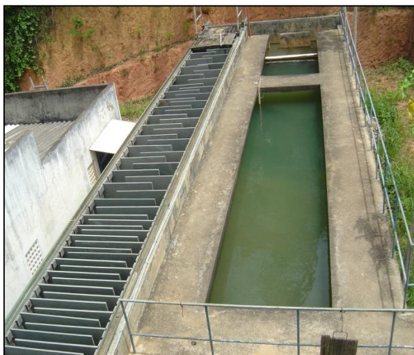
Figura 23 - Vista da ETA Avelar 1
